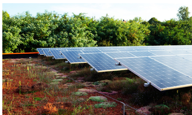
Impianto solare su tetto piano
